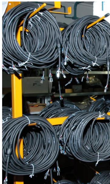
Cable storage (manufacturing) Kabelspeicher (Fertigung)
